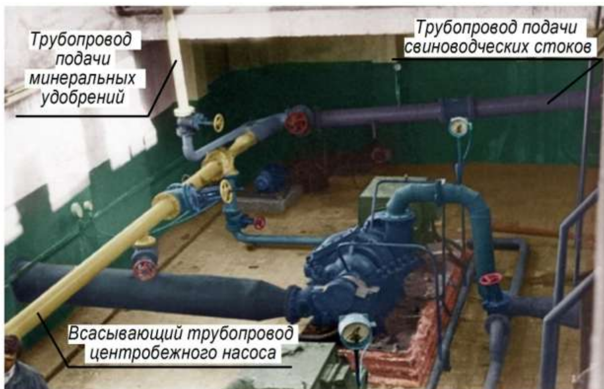
Рисунок 1.7 – Ввод животноводческих стоков в насосной станции ООО «Калалинское» Ставропольского края (общий внутренний вид насосной станции)
