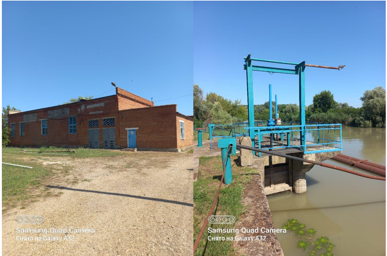
Рисунок 3.1 – Насосная станция первого подъёма с водозабором из р. Кубань Темрюкского района Краснодарского края. Общий вид
