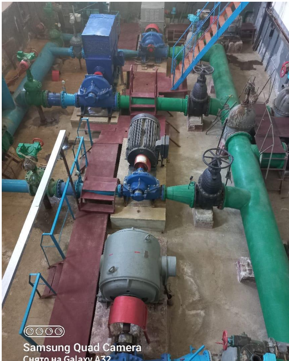
Рисунок 3.2 – Внутренний вид насосной станции с насосным агрегатом Д 1600-90. Общий вид
