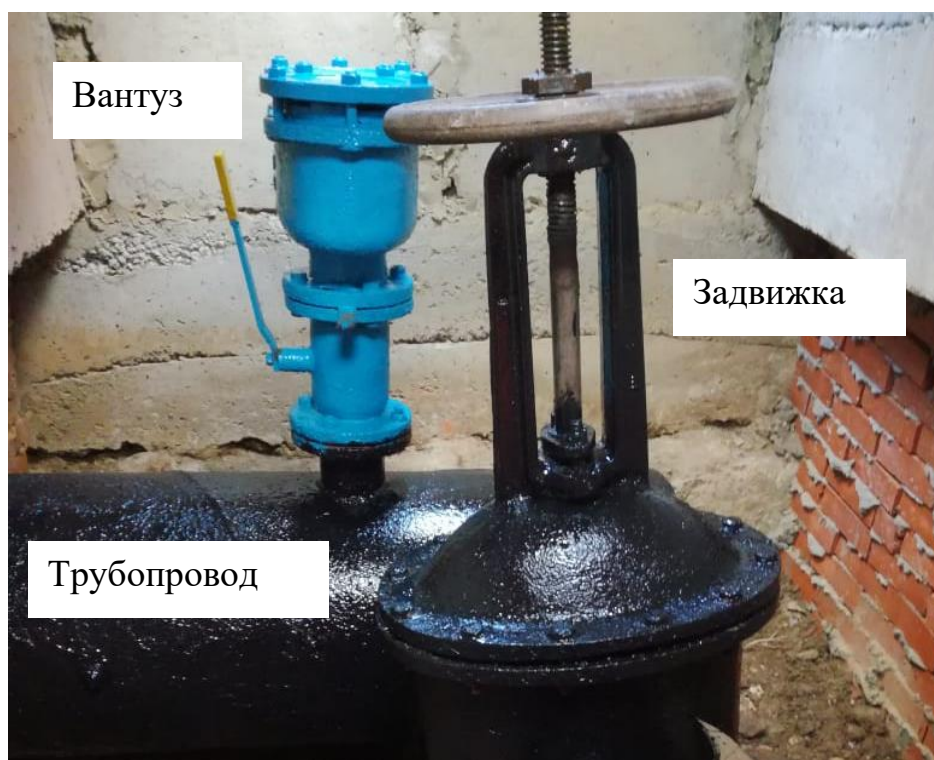
Рисунок 5.1 – Колодец с задвижкой и клапаном сброса воздуха – вантузом на трассе напорного трубопровода насосной станции первого подъёма Темрюкского района Краснодарского края. Общий вид
